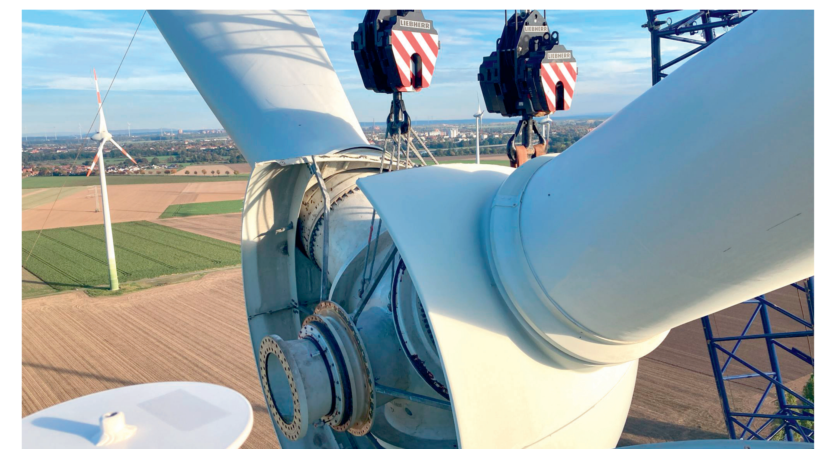
Erneuerung eines Windparks: Weniger Anlagen, mehr Ertrag.
